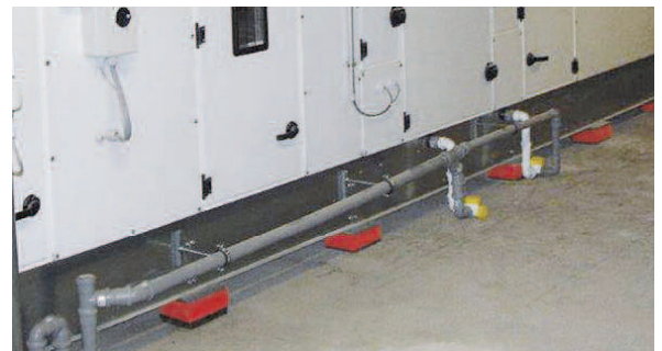
Bild 1 (ovan): Sylomer® för ett takmonterat AC-system
